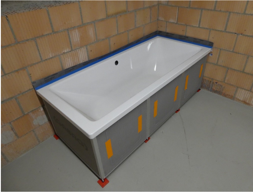
Abbildung 3: Gesamtansicht von Prüfaufbau 1 (Aufbau Nr. 3 vom 02.12.2020)
